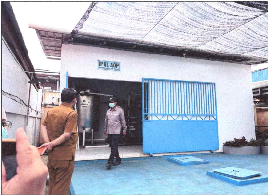
Gambar 6 IPAL AOP (Advance Oxydation Proses) IPAL Oksidasi Lanjutan)
